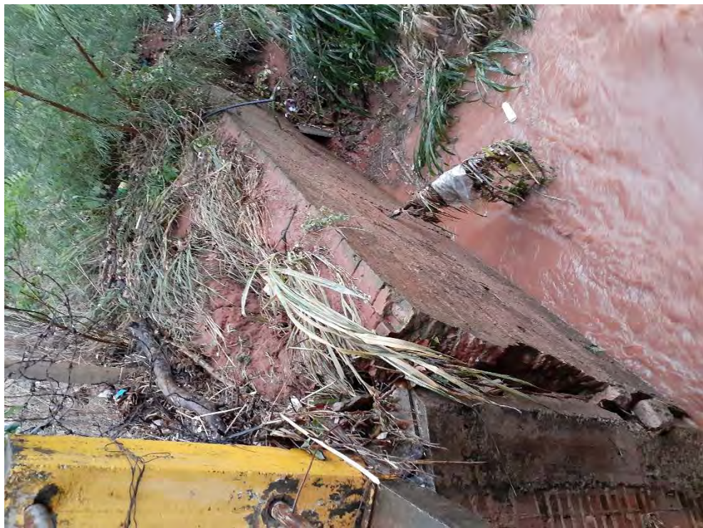
Imagem da Ala de proteção prejudicada devido ao alto grau de atividade erosivo no local, em 11/02/2020.
