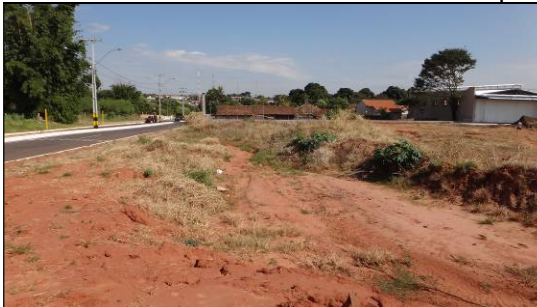
Foto 30 – Processo erosivo-Nova Parapuã.
