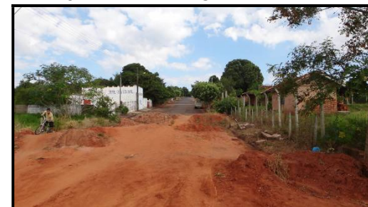
Foto 8 - Rua Erosão Curitiba.
