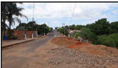
Foto 9 – Erosão Avenida São Paulo.
