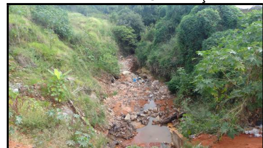
Foto 7 - Erosão final da Canalização.
